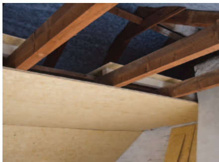
Die Dachbalken verschwinden passgenau hinter den OSB-Platten, ebenso wie die 20 Zentimeter starke Zellulose-Dämmung.
